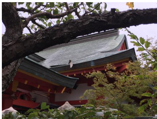
銅板のめくれ、屋根右上棟の鬼板落下
