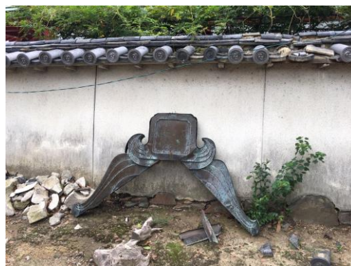
上の写真屋根右上棟から落下した鬼板
